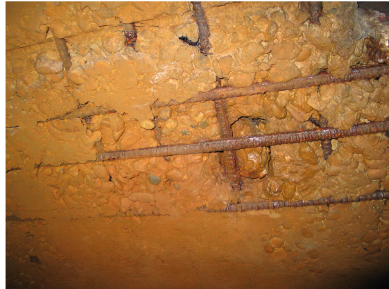
【밸브실 상부슬래브 콘크리트 파손】
