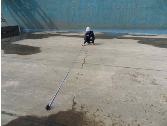
【정수장 응집침전지 바닥슬래브 균열】
