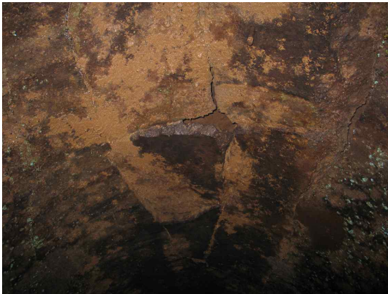
【라이닝 콘크리트 탈락】
