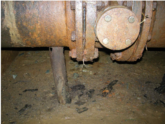
【밸브 받침 콘크리트 미설치】
