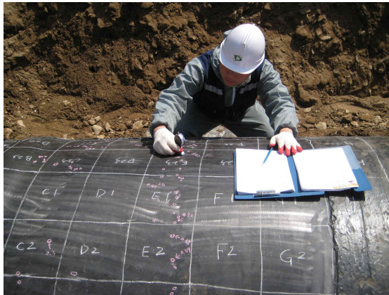
【관 외면 부식깊이 측정】
