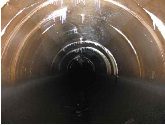
【횡방향 균열, 시공이음부 백태】
