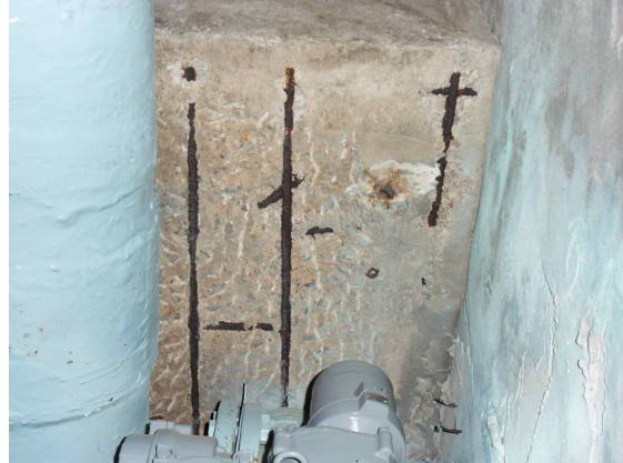
【정수장 여과지 배관실 상부슬래브 철근 노출】
