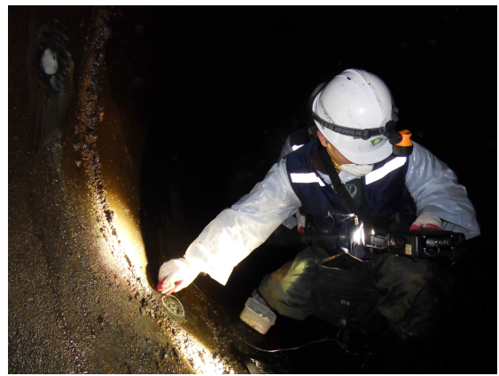
【관 내면 부식깊이 측정】
